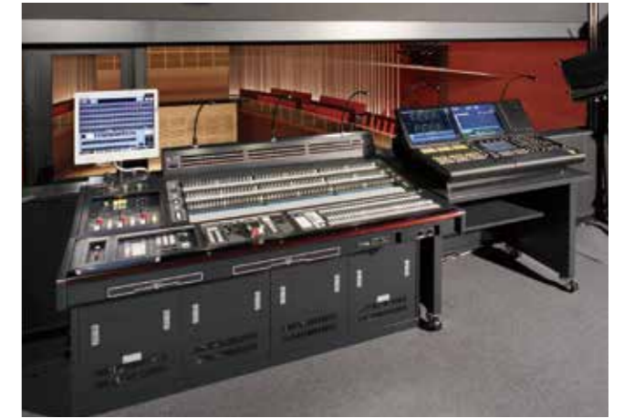
長岡リリックホール コンサートホール (据置型) Nagaoka Lyric Hall Concert Hall 新潟県長岡市 Nagaoka city, Niigata pref.
